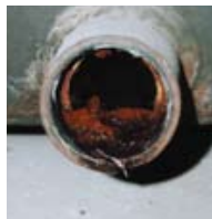
ボイラー下部 WW処理前
